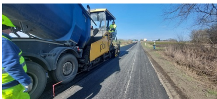
Wyrównanie podbudowy przy remoncie DP Nr 1674R Lubaczów - Laszki - Duńkowice w m. Korzenica_2
