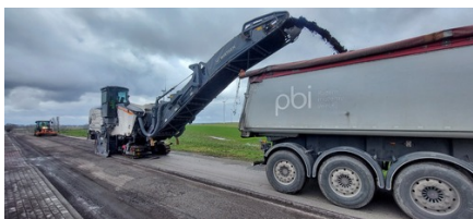
Frezowanie nawierzchni przy remoncie DP Nr 1674R Lubaczów - Laszki - Duńkowice w m. Korzenica
