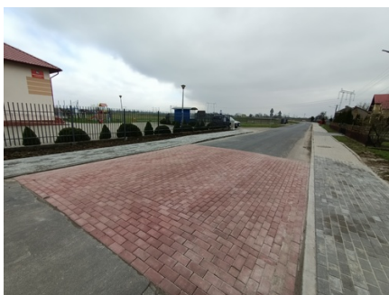
Budowa przejścia dla pieszych w miejscowości Kostków w ciągu DP Nr 1701R- Gorzyce - Kostków - Pełkinie
